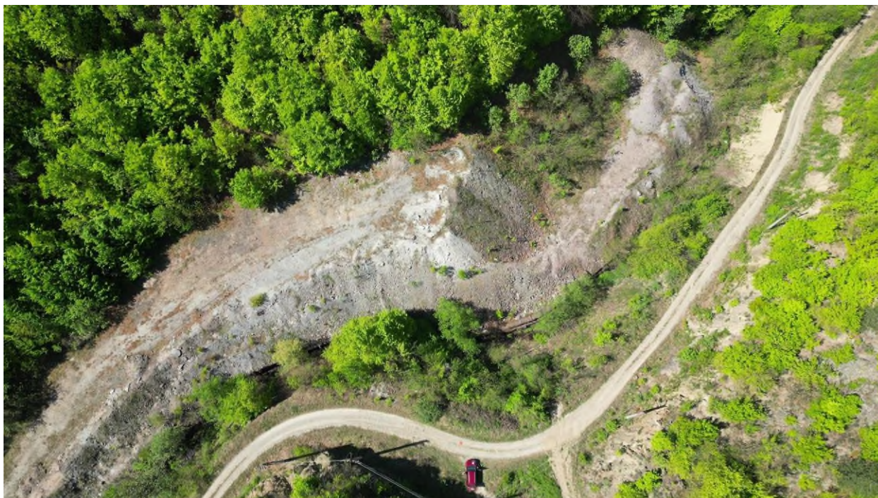
Fig. 58 – Fotografie aeriană asupra capătului aval al perimetrului șantierului ferestrei de atac Bolvașnița 2
