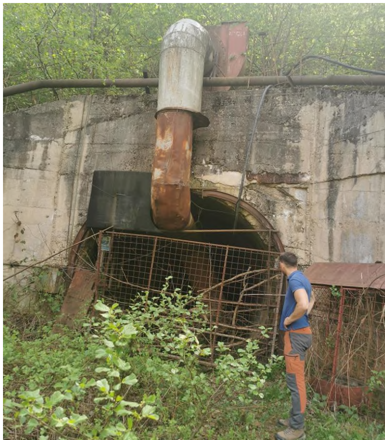
Fig. 34 – Intrarea în galeria de aducțiune din arealul barajului Cornereva (diam. 4,6 m). Vegetația ruderală (habitat din sistemul românesc de clasificare) adiacentă este înlocuită progresiv de păduri ripariene (habitatul 92A0)
