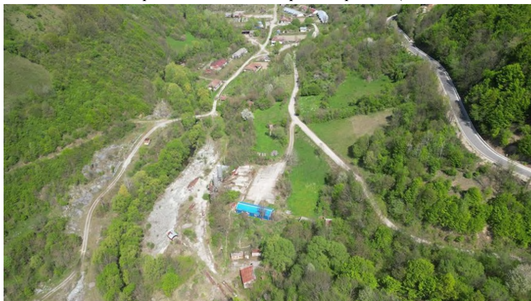
Fig. 27 – Imagine aeriană cu arealele puternic disturbate de lucrările de șantier din arealul aval al viitorului lac de acumulare Cornereva, în punctul unde începe galeria de aducțiune spre Cerna
