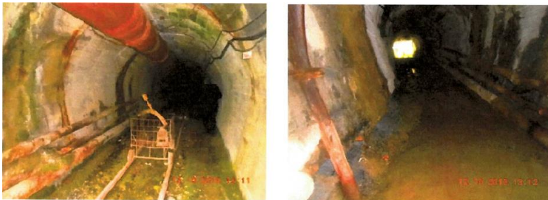
Figura 9 - Galeria de aducțiune. Front priza Cornereva
