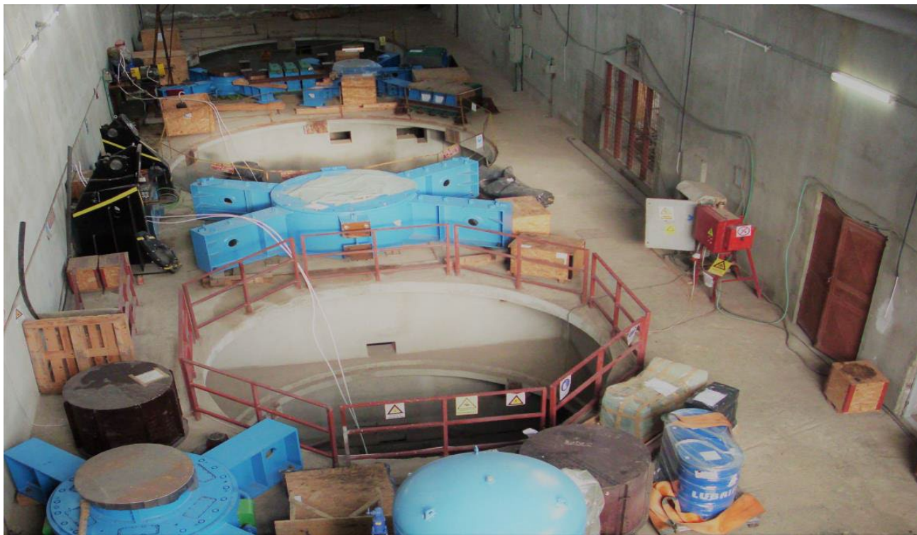
Figura 20. Echipamente livrate și depozitate în interiorul CHE Pașcani
