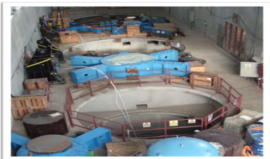
Figura 23 Vedere interior CHE Pașcani Turbine
