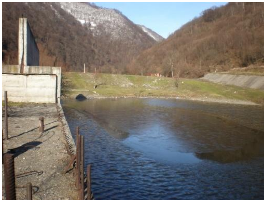
Foto nr. 19 - CHE Lotrioara - incinta de execuție inundată
