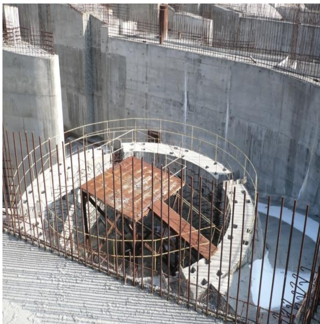
Foto nr. 13 – CHE Căineni - centrala– zona camere spirale
