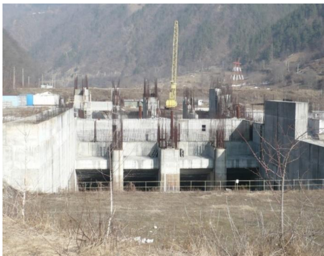
Foto nr. 11 – CHE Căineni - centrala si bazinul de liniștire – vedere din aval
