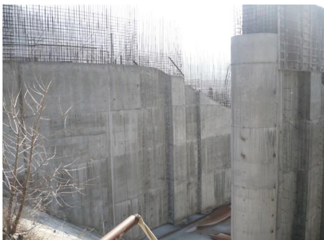
Foto nr. 15 - CHE Câineni - centrala- zona prizei-vedere din amonte
