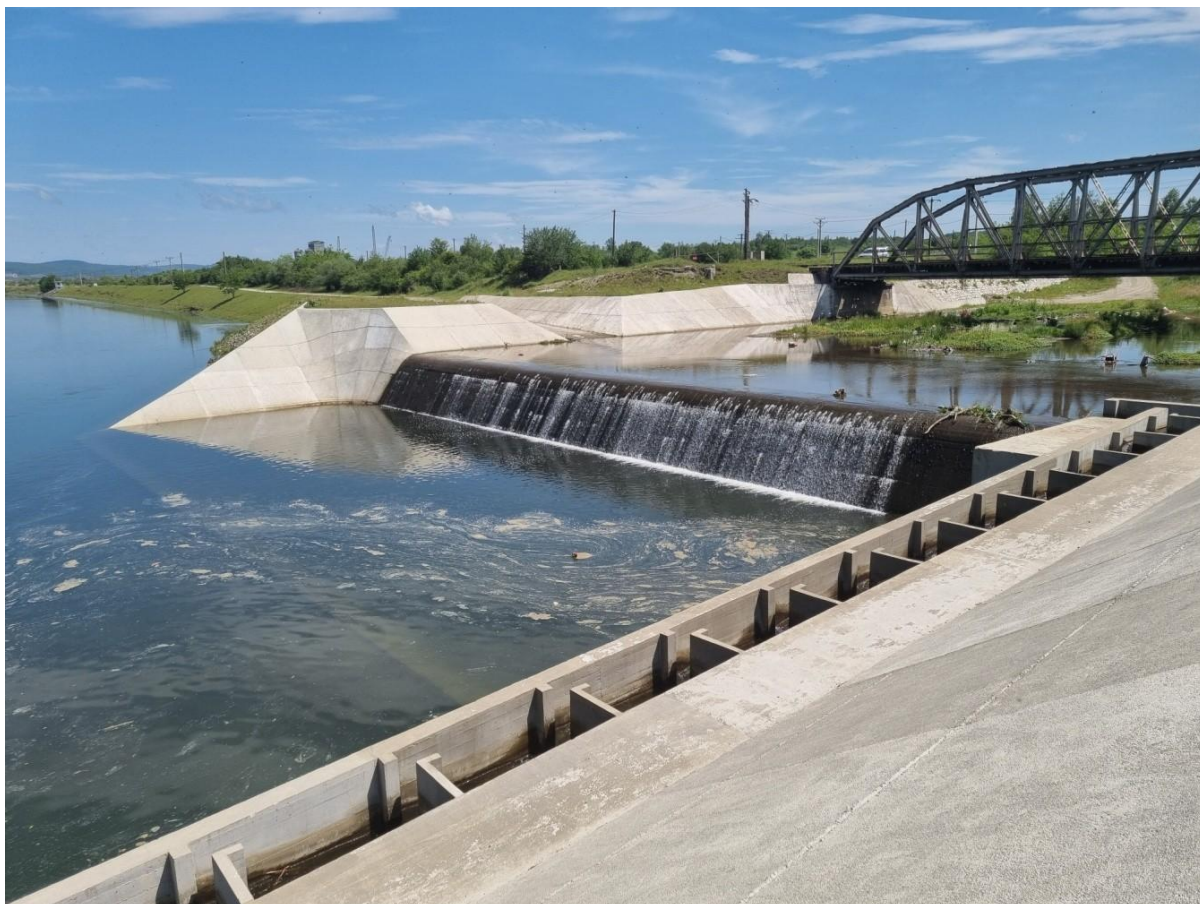
Foto nr. 58 Deversor confluență pr. Șebeș cu r. Olt
