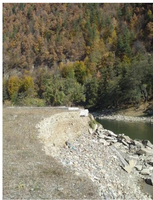
Foto nr. 10 - CHE Căineni - dig mal drept- amonte racord cu centrala – umplutură platformă ecran tip Kelly spălată de apele mari pe cca. 4-5 m lățime și grinzile de ghidaj prăbușite
