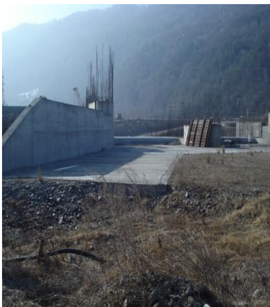
Foto nr. 7 - CHE Căineni - zid amonte mal stâng primul tronson și regularizare amonte
