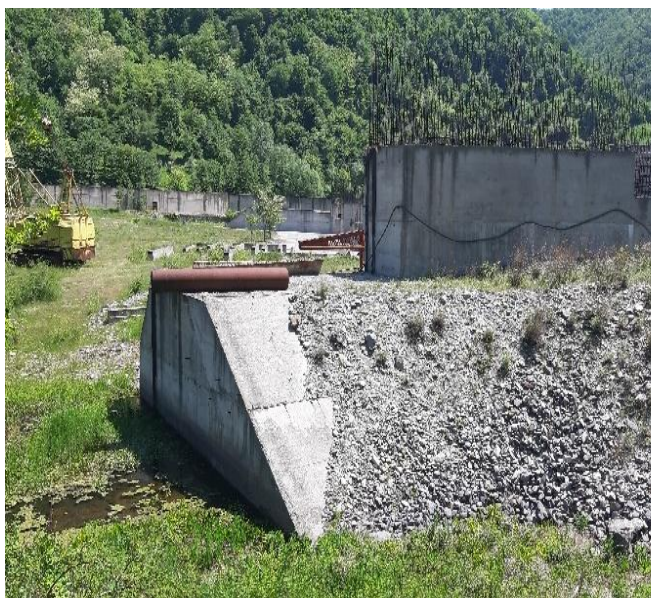
Foto nr. 8 - CHE Căineni - Zid amonte mal drept executat
