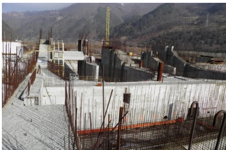
Foto nr. 16 - CHE Câineni - Centrala- zona prizei si camere spirale - vedere din aval
