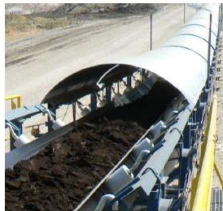
Figura 3.3.4-8: Un exemplu de sistem dezvoltat pentru acoperirea transportorului (transportor pentru cărbune concasat în TPP Stanari)
