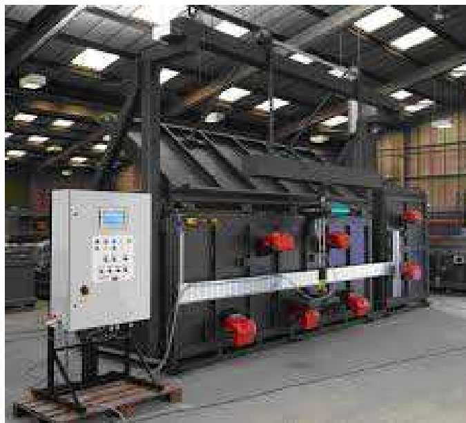
Figură 2: vedere incinerator din spate (zona arzătoarelor)
